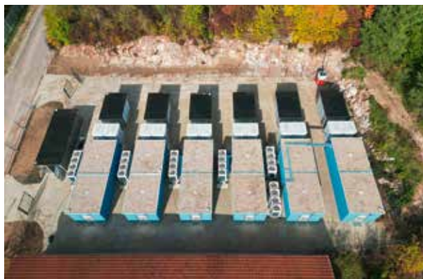
VRF-Außeneinheiten von Panasonic zur Klimatisierung der Batteriespeicheranlage.
