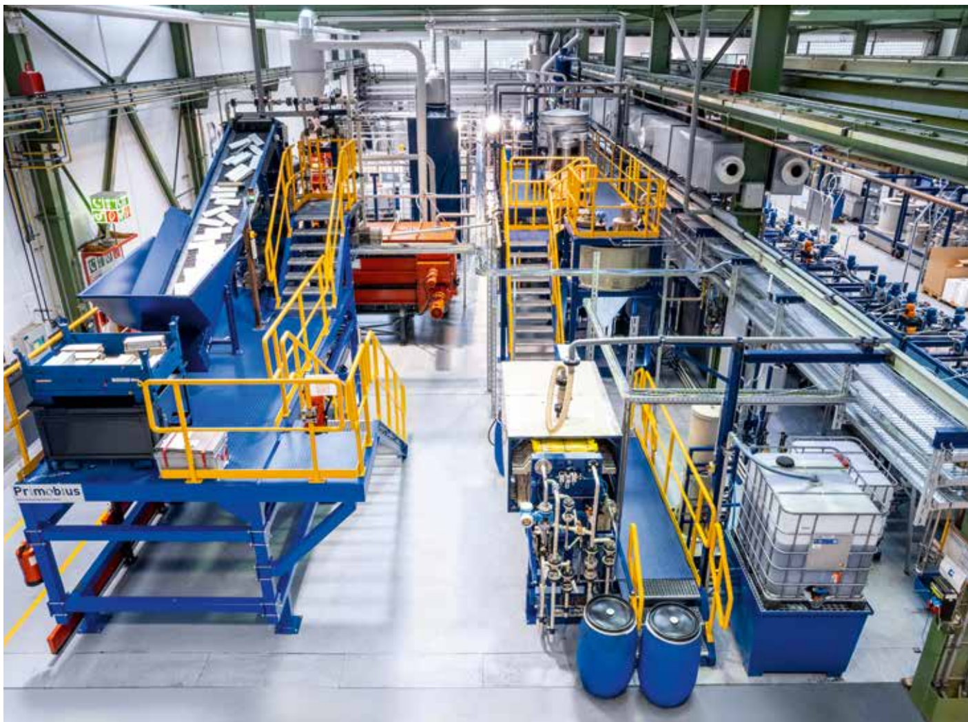
Demonstrationsanlage des SMS-JV Primobius für das Recycling von Lithium-Ionen-Batterien am Standort Hilchenbach.
