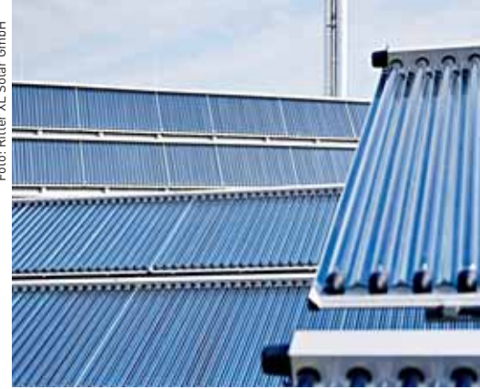
Mit Solarthermie können Prozesse in Industrie und Gewerbe unterstützt werden.
