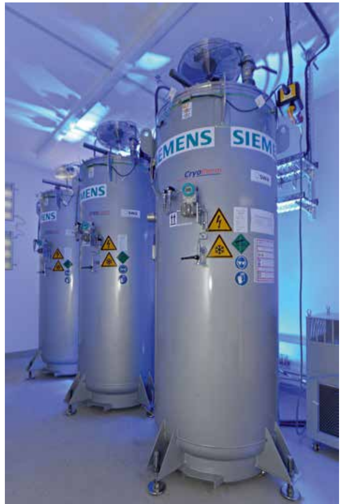
Ohne Verluste: Der weltweit erste supraleitende Strombegrenzer ging bei den Stadtwerken Augsburg in Betrieb
