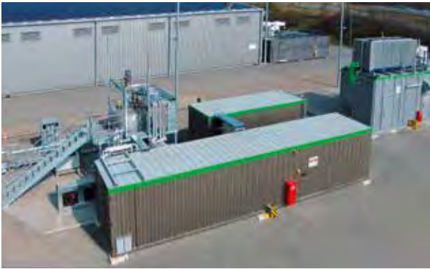
Die Anlage in Allendorf erzeugt mittels biologischem Verfahren aus regenerativem Strom Methan, das ins öffentliche Erdgasnetz eingespeist wird; Foto: Viessmann
