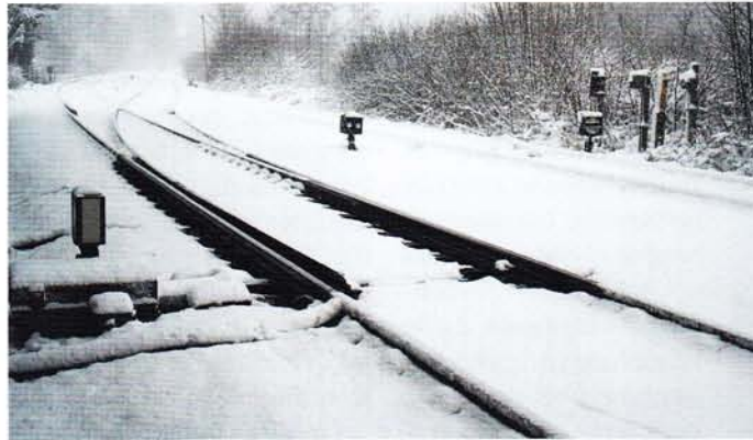
Dank der Weichenheizungserprobung der Deutschen Bahn bleibt die Weiche in Burbach eisfrei
