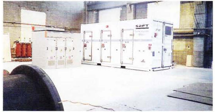
Bild 5: ESS-Batterien und Umrichterschränke in einer Anlage in Philadelphia, USA
