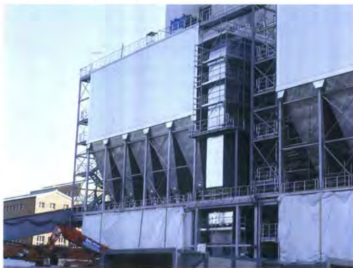
Fertig montierte Gewebefilteranlage der Kessellinie 9
