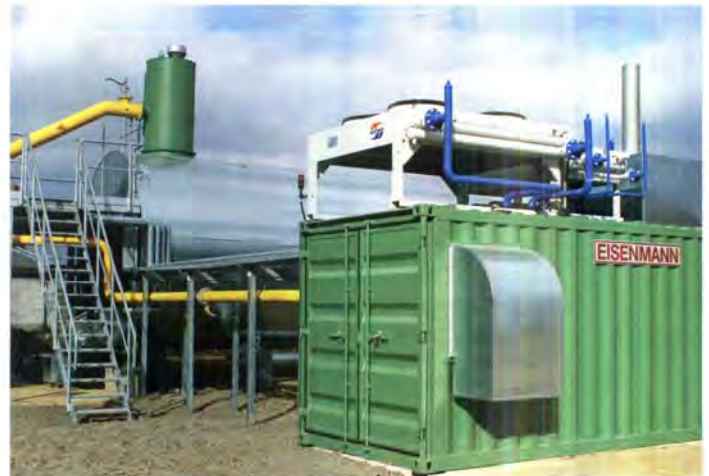
Bild 3: Das Blockheizkraftwerk liefert bei voller Leistung annähernd 3.000.000 kWh pro Jahr
