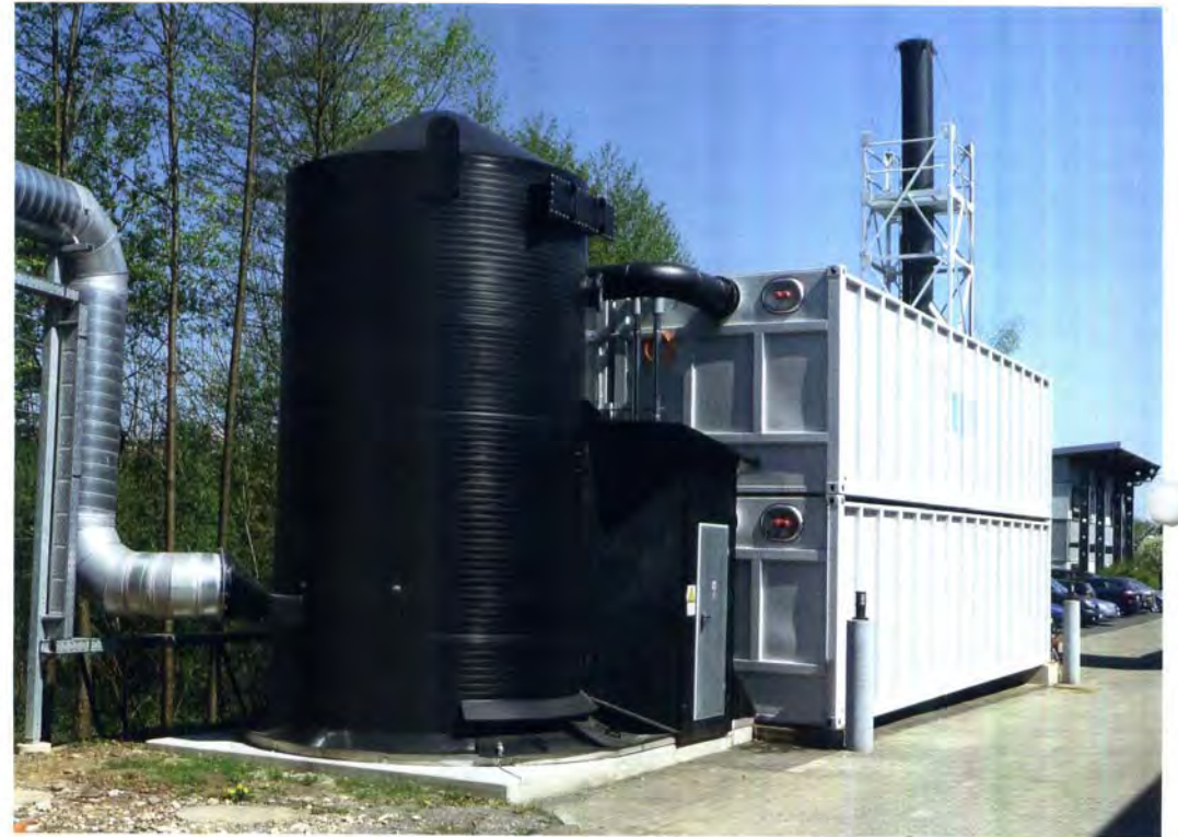
Bild 1: In einer zweistufigen biologischen Abluftbehandlungsanlage wird die Abluft aus der Zinklamellenbeschichtung effektiv gereinigt.
