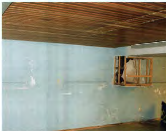
Bild 1: Ein dauerhaftes Provisorium zur Sicherung eines Abwasserrohres kann Schäden an der Bausubstanz nicht verhindern.
