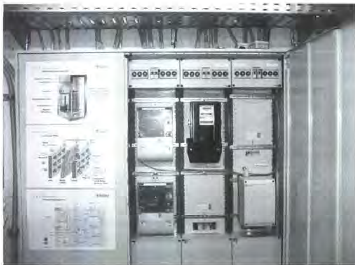
Besonderheit im Zählerkasten: Ein zweiter Zähler registriert den von der Brennstoffzellenheizung produzierten und ins Netz gelieferten Strom.
