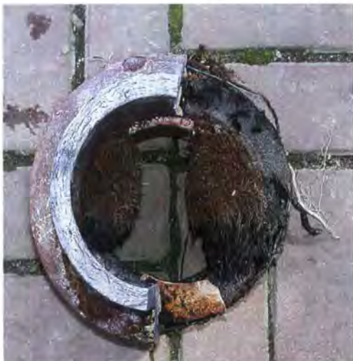
Bild 1: Wurzeln im Schmutzwasserkanal
