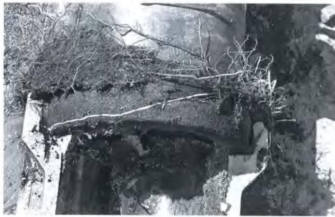
Bild 3: Die Wurzel hat sich den Rückzug selbst „verbaut“ und wächst durch die Dichtung in das Rohr hinein.
