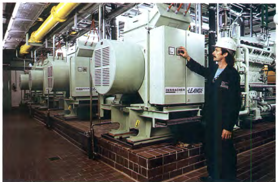
Mit Deponiegas als Brennstoff bedarf es immer der besonderen Wartung für die acht Motoren – einer von ihnen ist immer an der Reihe
